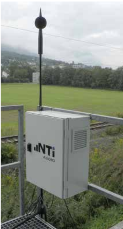
噪声监测终端 麦克风装在三脚架上
